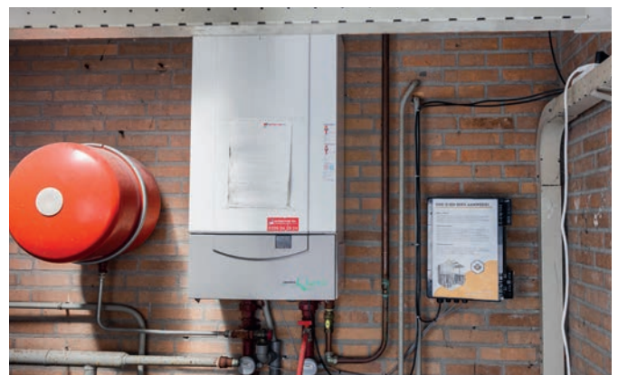
Der Hero Balancer steuert die Heiz- und Klimatechnik so effizient wie möglich und schafft ein optimales Raumklima Bild: Hero Balancer
