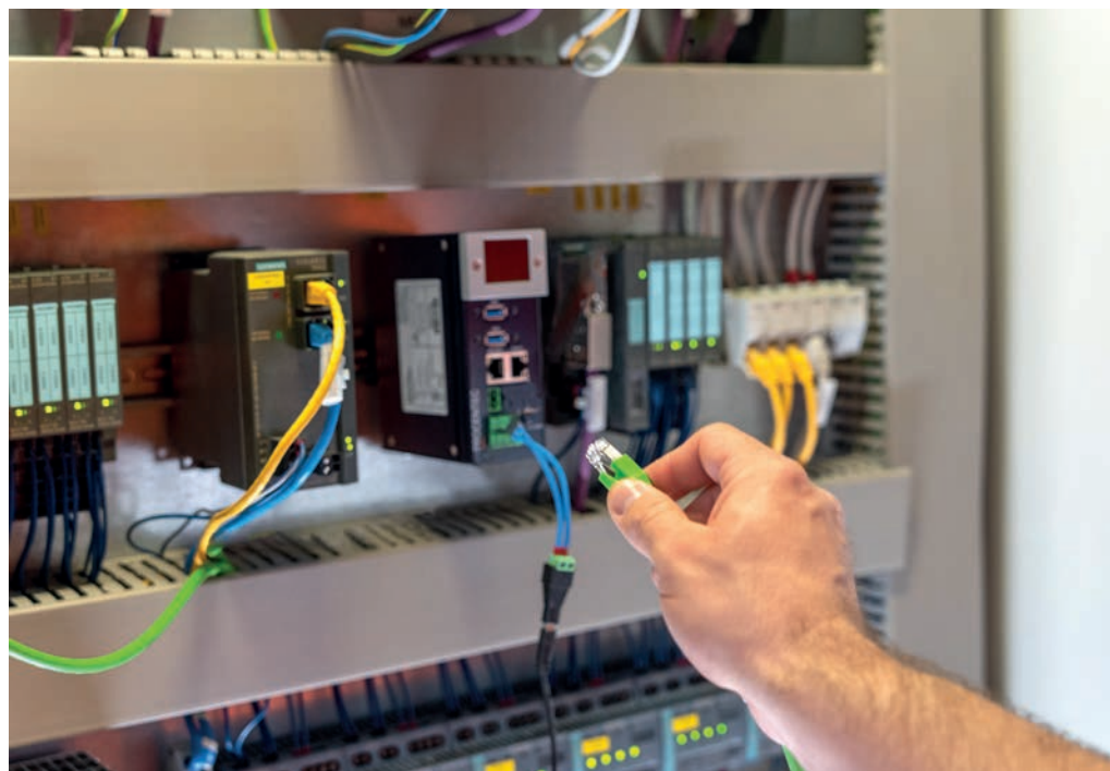
Nicht jeder Schaltschrank hat schon sein optimales Performance-Level erreicht.
